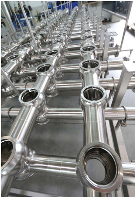
Hochwertige Ventilknoten sind wichtige Bauteile in Produktionsanlagen der Getränkeindustrie. (Bilder: Walter Lutz)
